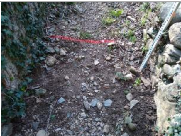
Débris végétaux au sol + limite d'érosion
