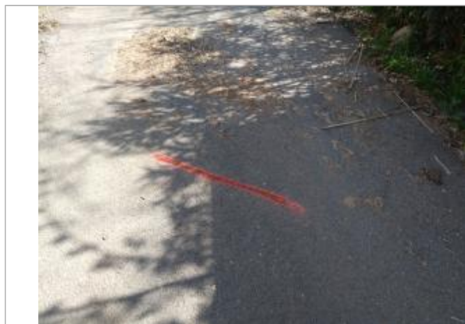
Dépôt sur la chaussée
