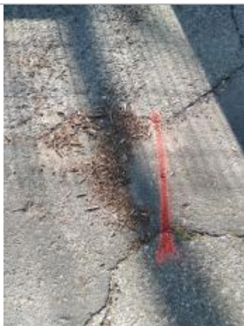
Dépôt sur la chaussée
