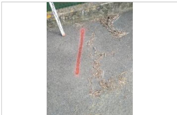
Dépôt sur la chaussée
