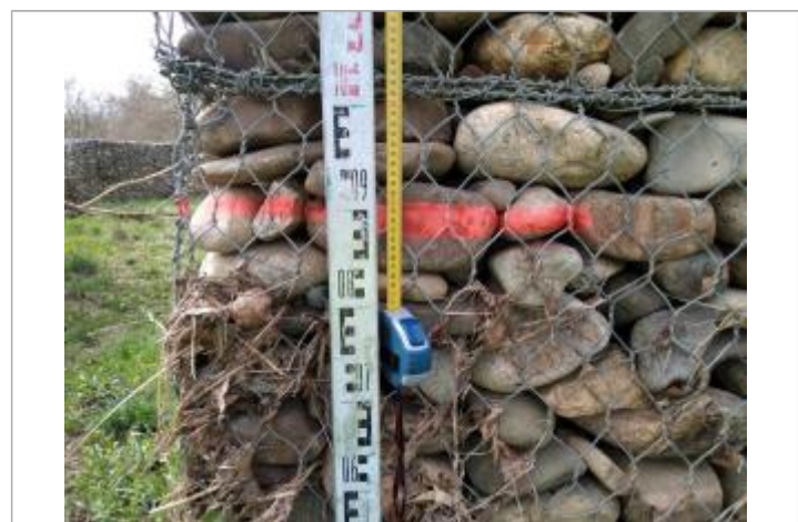
Débris végétaux accrochés aux gabions
