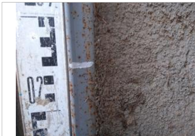
Trace dans l'ouvrage
