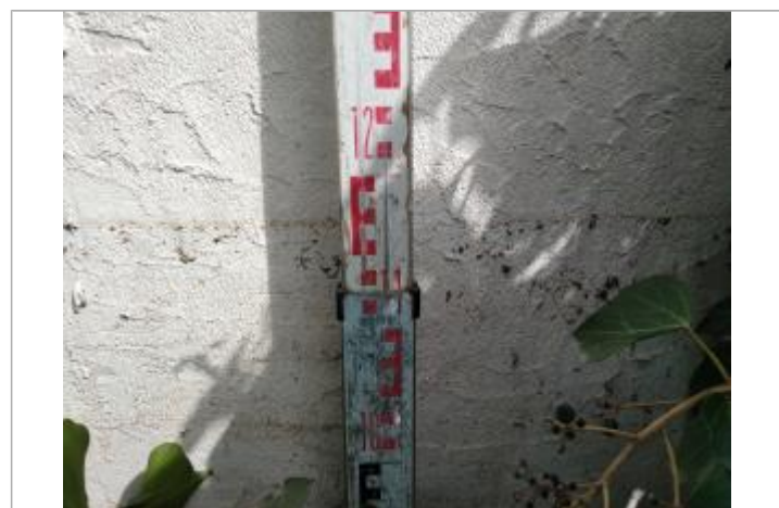
Trace sur le mur
