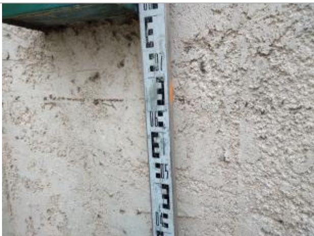
Trace sur le mur
