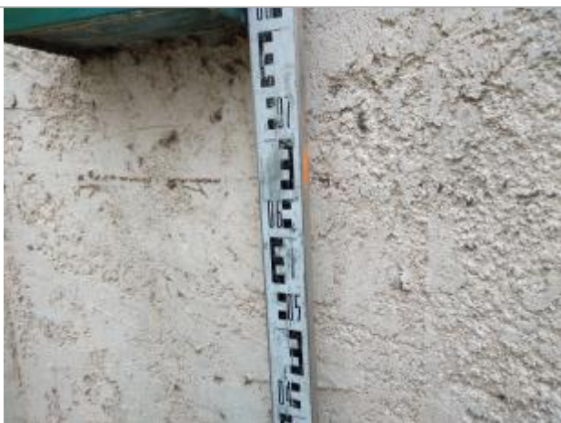
Trace sur le mur
