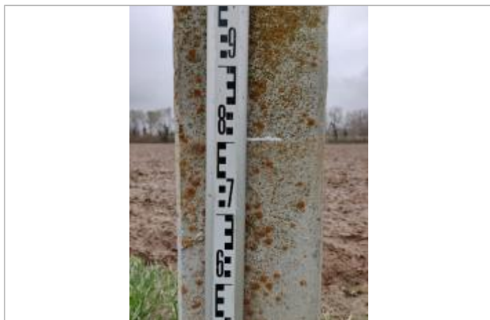
Trace sur le pylône
