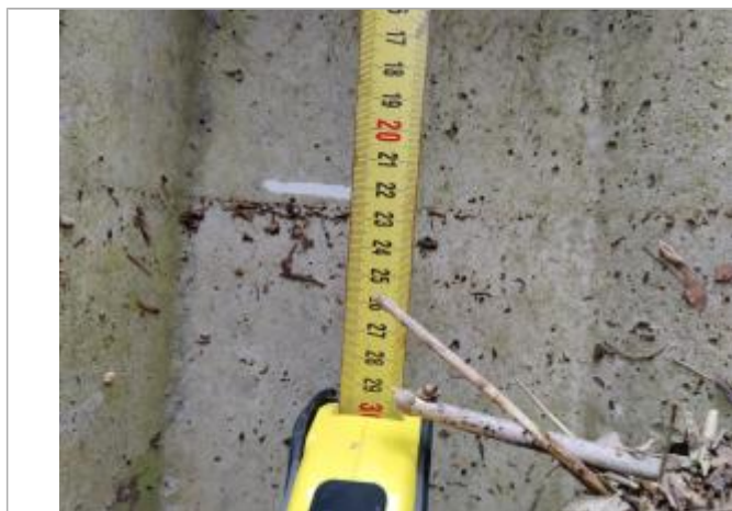
Trace sur le pylône
