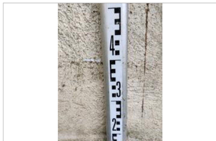
Trace sur le mur
