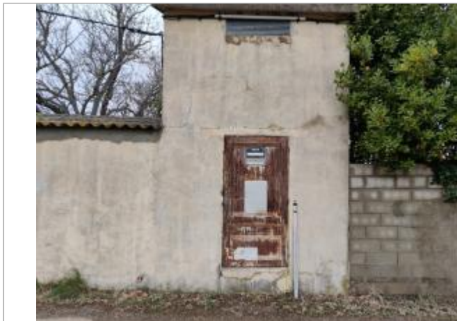
Ancien poste électrique
