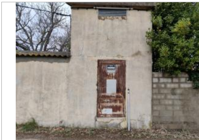
Ancien poste électrique
