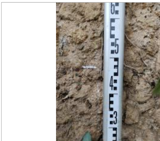
Trace sur le mur
