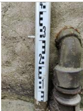
Trace sur le mur du bâtiment
