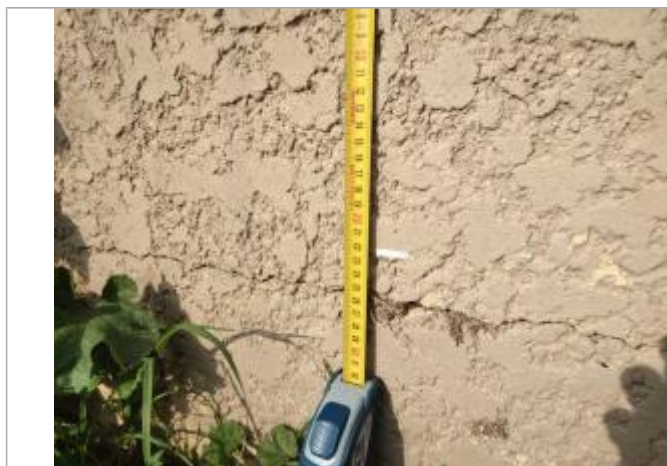
Trace sur le muret
