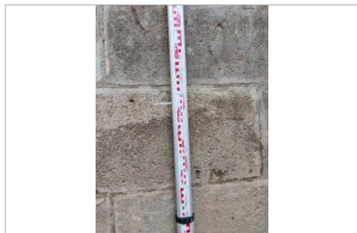
Trace sur la culée RD
