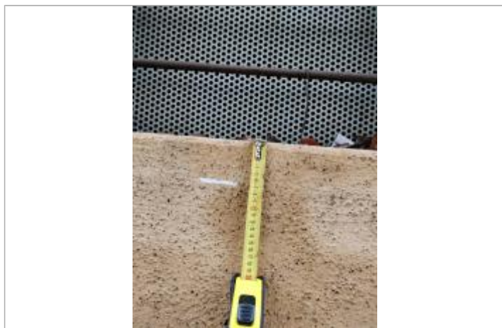
Trace sur le mur
