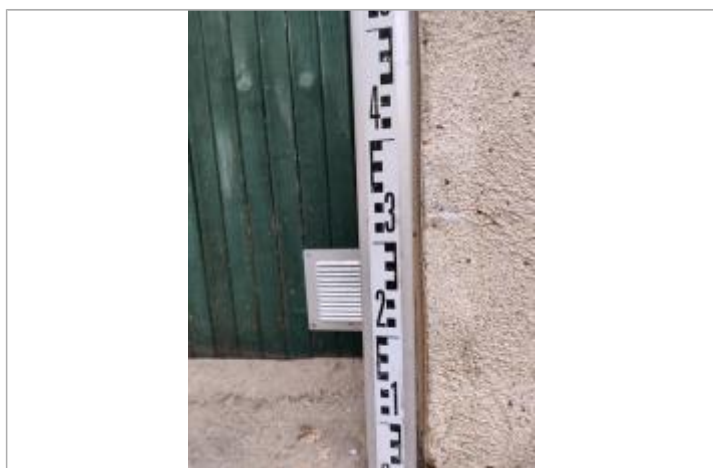
Trace sur le mur
