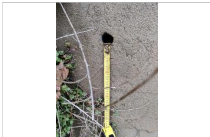
Trace sur le mur
