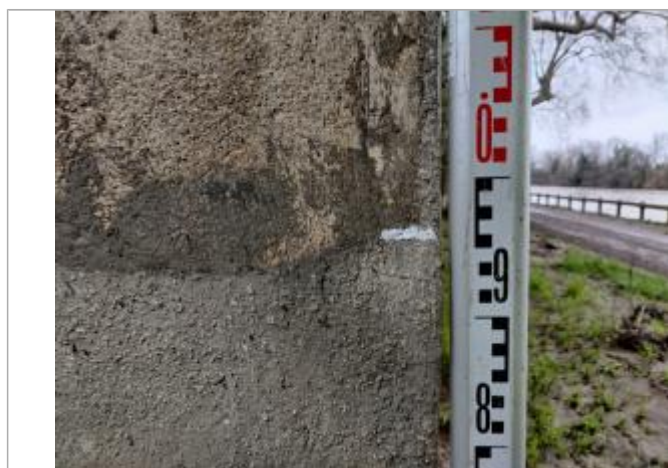
Trace sur le mur
