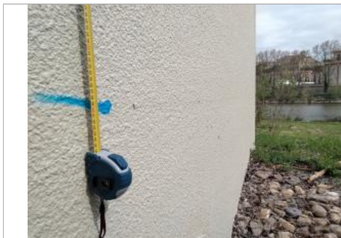
Trace sur le mur
