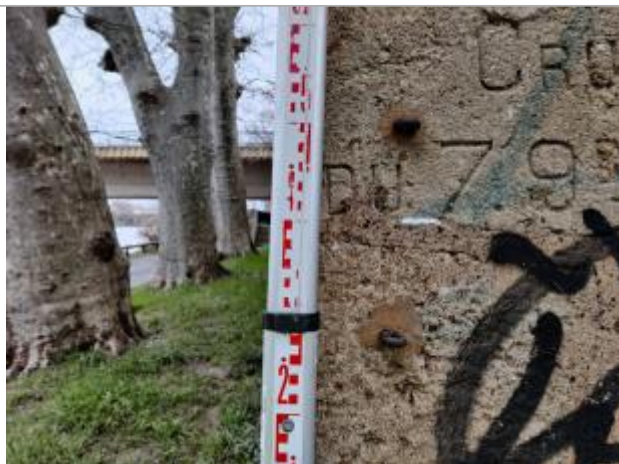
Trace sur le mur
