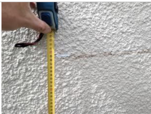
Trace sur le mur
