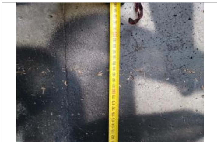
Trace sur le sous-poutre
