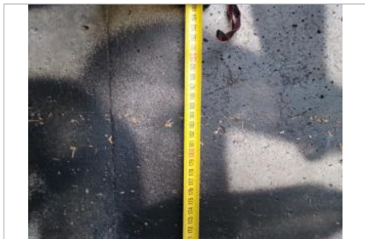
Trace sur le sous-poutre
