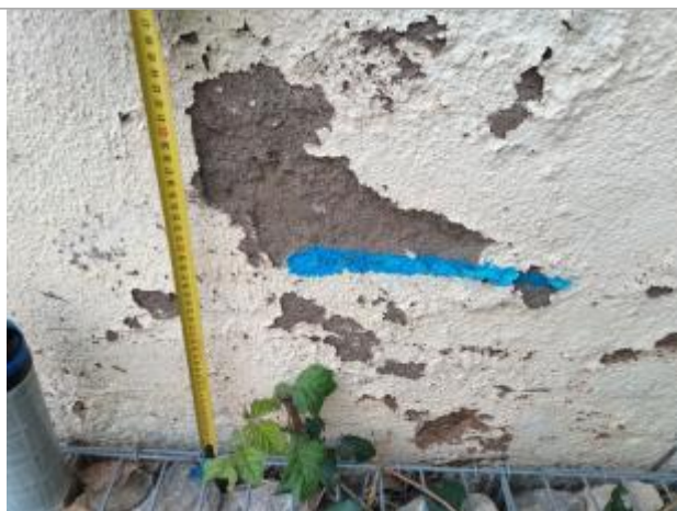
Trace sur le mur
