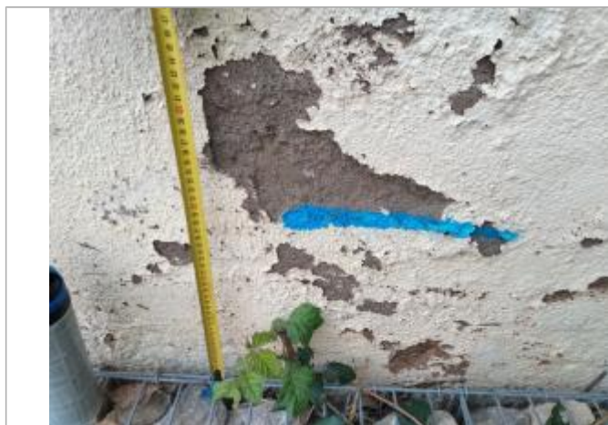
Trace sur le mur
