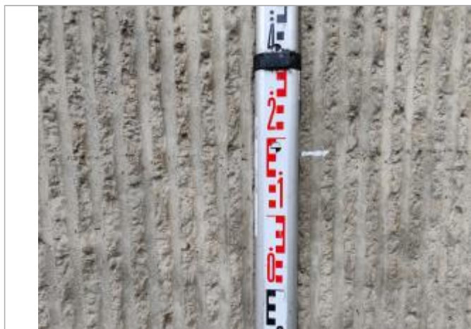
Trace sur le mur
