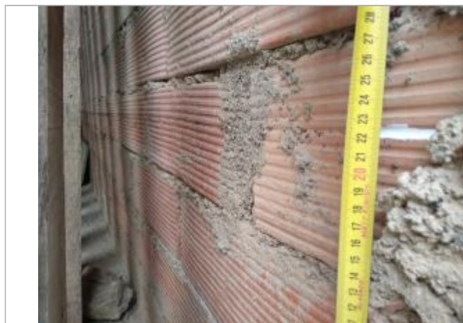
Trace sur le mur
