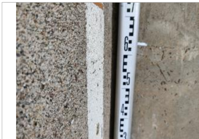
Trace sur le mur
