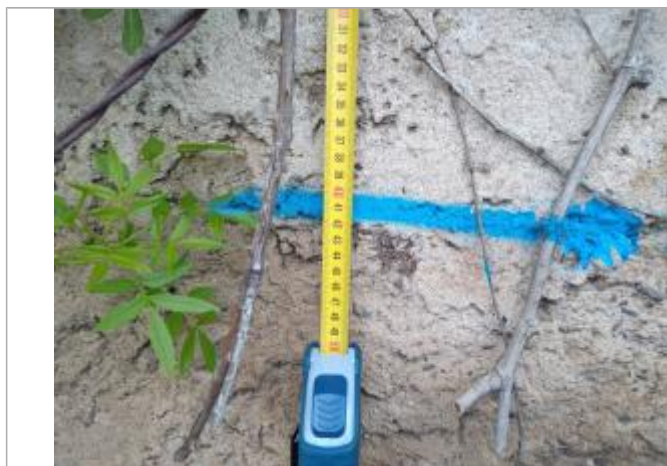
Trace sur le mur
