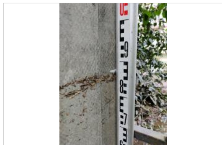
Trace sur le montant
