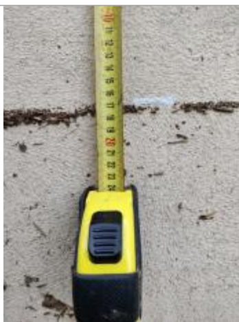
Trace sur le muret
