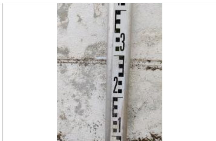
Trace sur la maçonnerie
