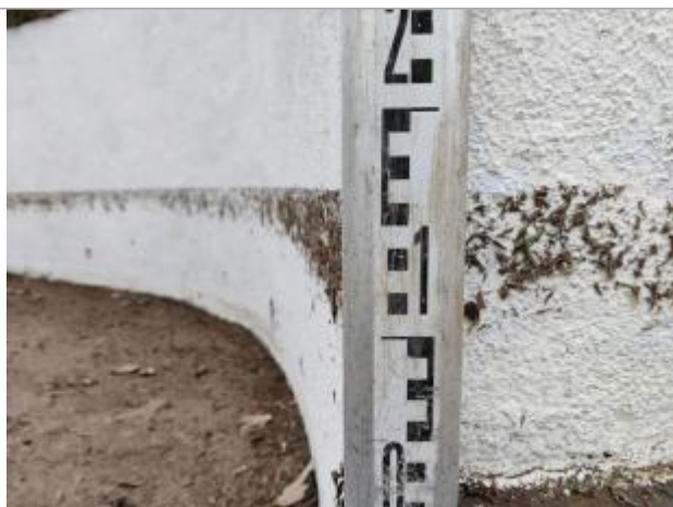
Trace sur le mur
