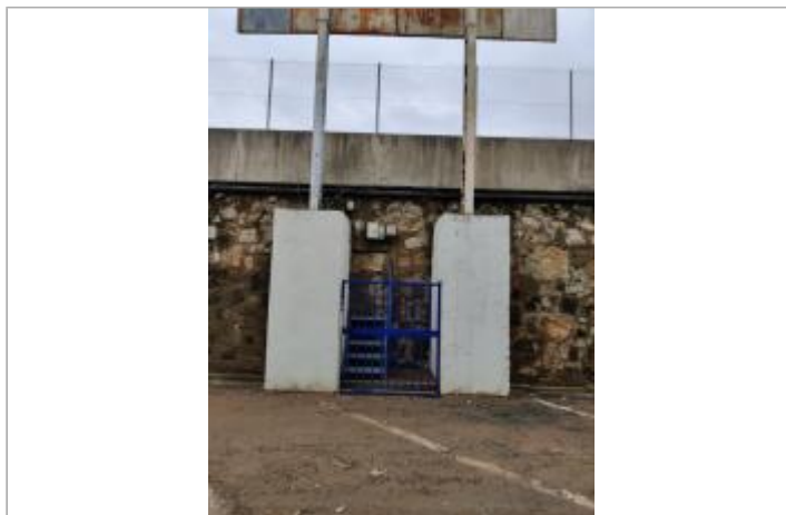
Portail bleu du tableau électrique
