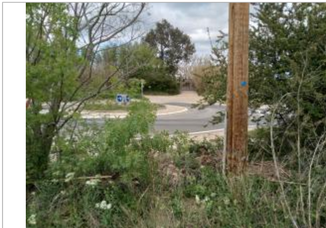
Pylône en bois
