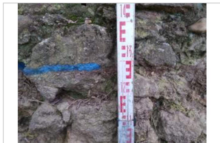
Trace sur le mur
