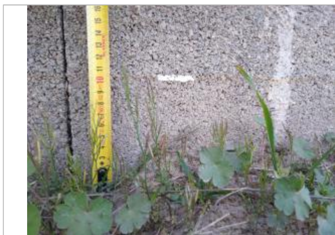
Trace sur le mur
