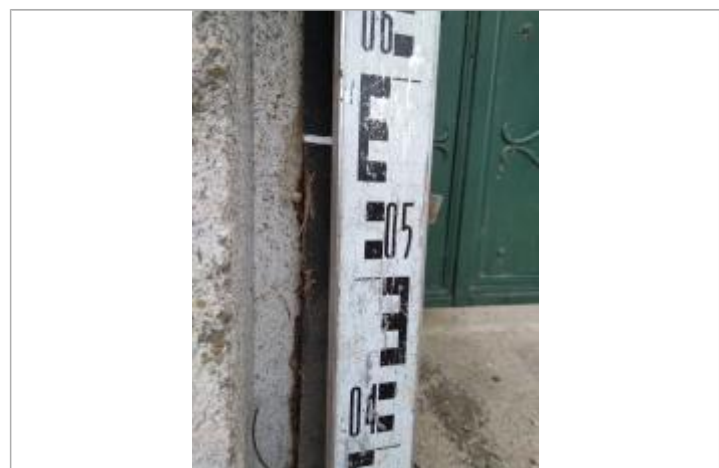
Trace sur le joint du portail
