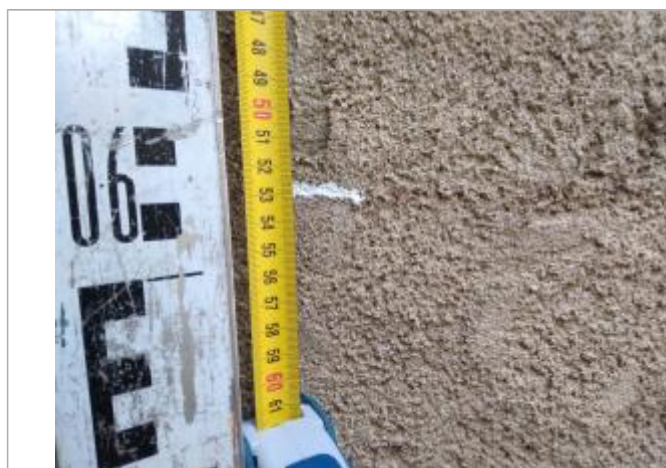
Trace sur le muret
