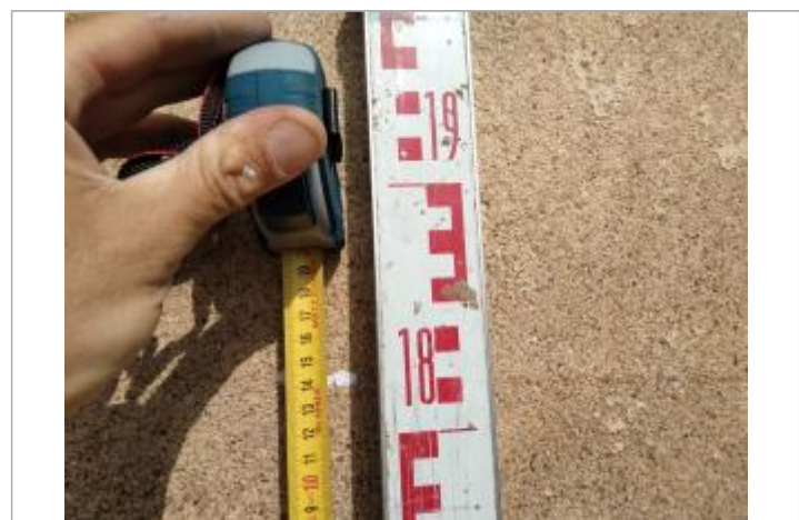
Trace sur le mur
