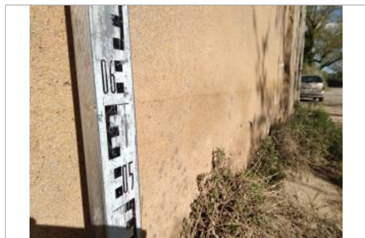
Trace sur le mur
