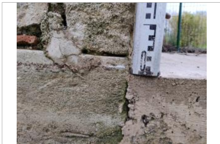
Trace sur le mur
