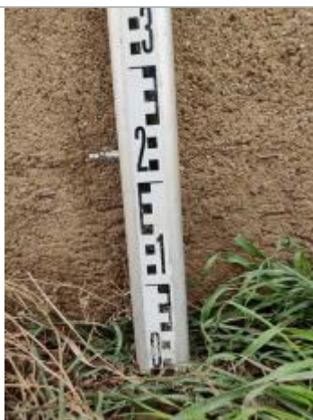
Trace sur le mur
