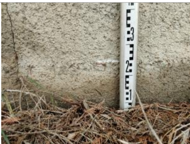
Trace sur le mur
