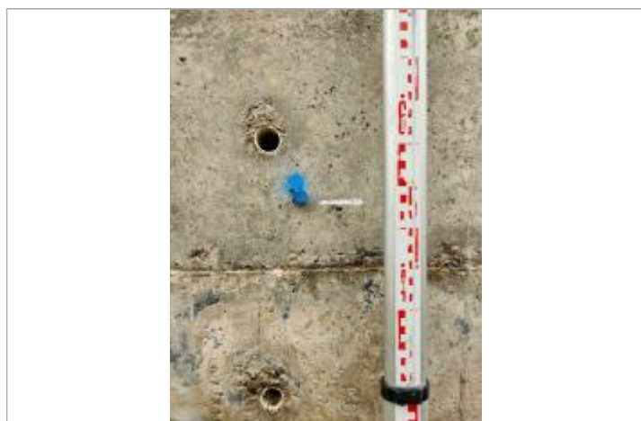
Trace sur la culée
