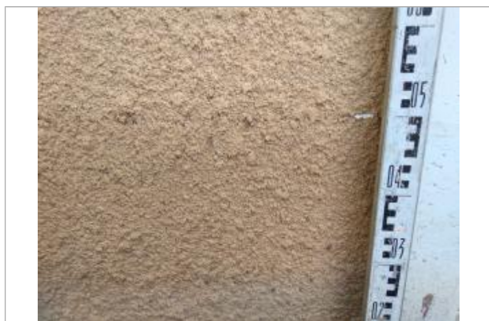
Trace sur le mur
