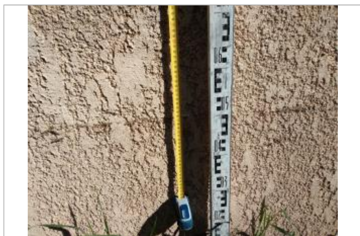
Trace sur le mur
