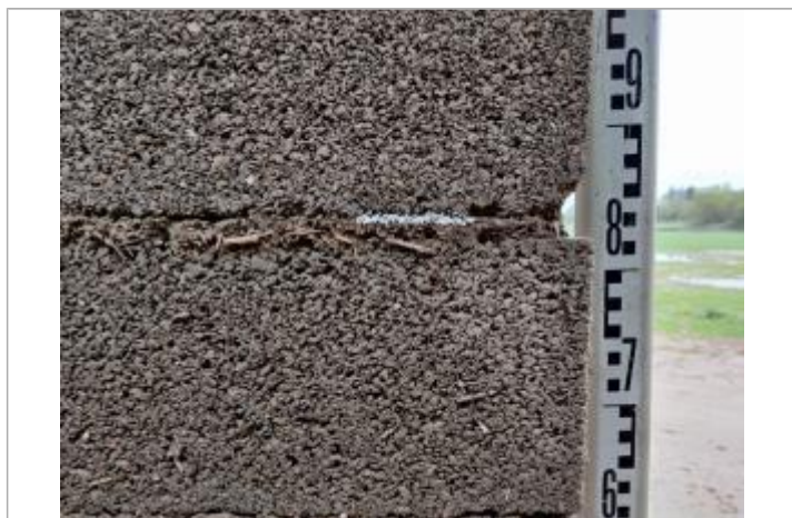
Trace sur le mur
