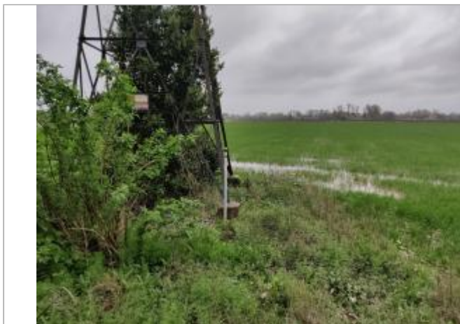
Pylône haute tension
