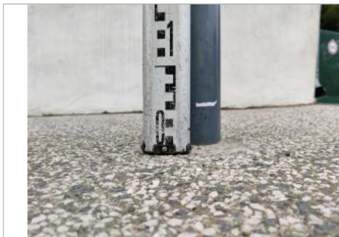
Trace sur le poteau
